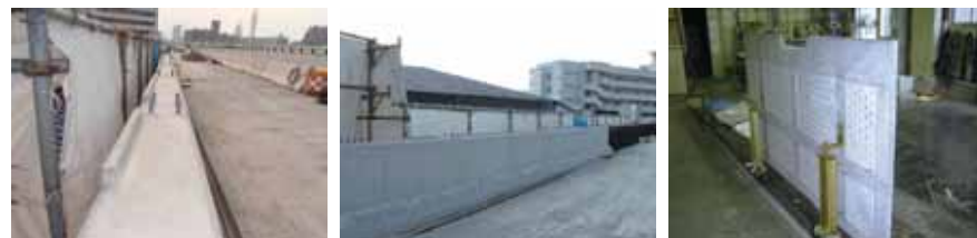
④天端付遮音壁アンカー
