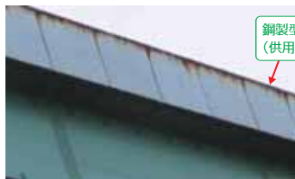
鋼製型枠の劣化状況
